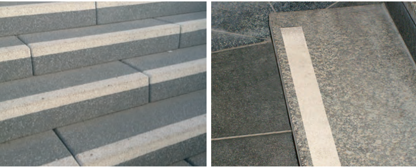
Treppenstufenmarkierung mit integriertem Kantenlement (links) und nachträglicher Applikation (rechts)
